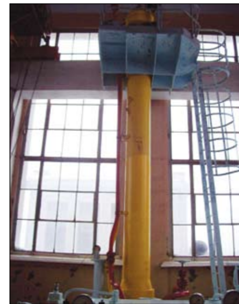
Рис. 1. Электрогидравлический привод подъемно-опускных ворот
